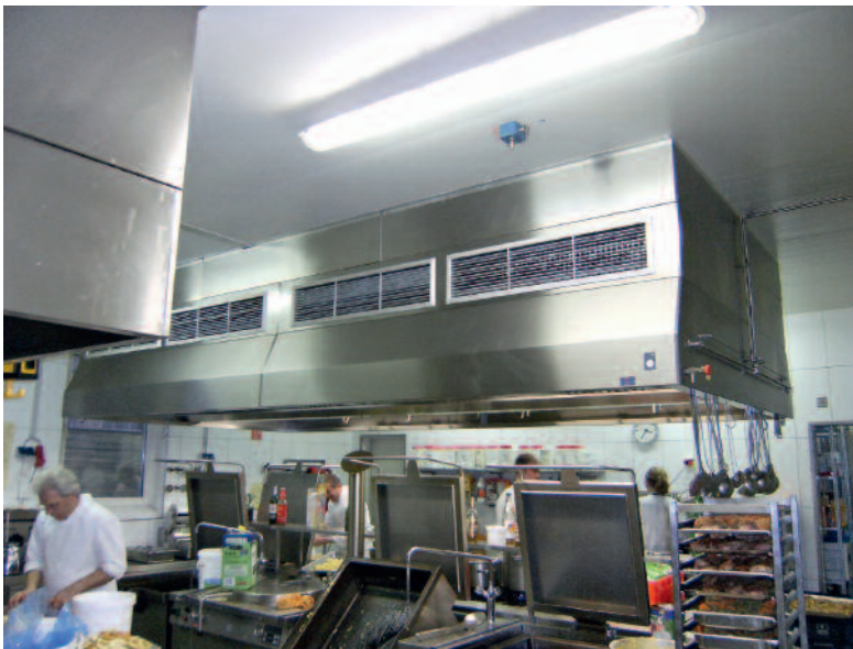
Bild 11 • Dunstabzugshaube mit integrierter Wärmerückgewinnung
